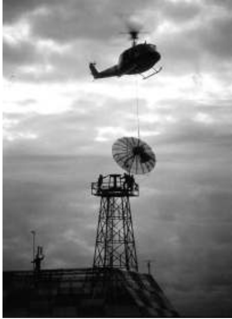
Instalación de radares en la Estación Eolo (gentileza Juan Carlos Oviedo).
