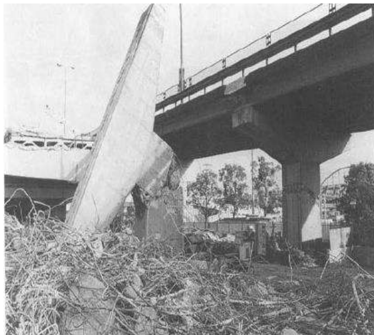
Figura 2.12. Falla por corte por interrupción abrupta de armadura, (Priestley et al., 1996).
