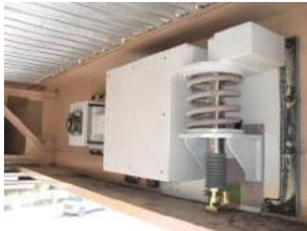
Figura. 2.36. Amortiguador de masa sintonizado instalado en el puente peatonal "three springs pedestrian bridge" de Las Vegas ( https://www.taylordevices.com ).
