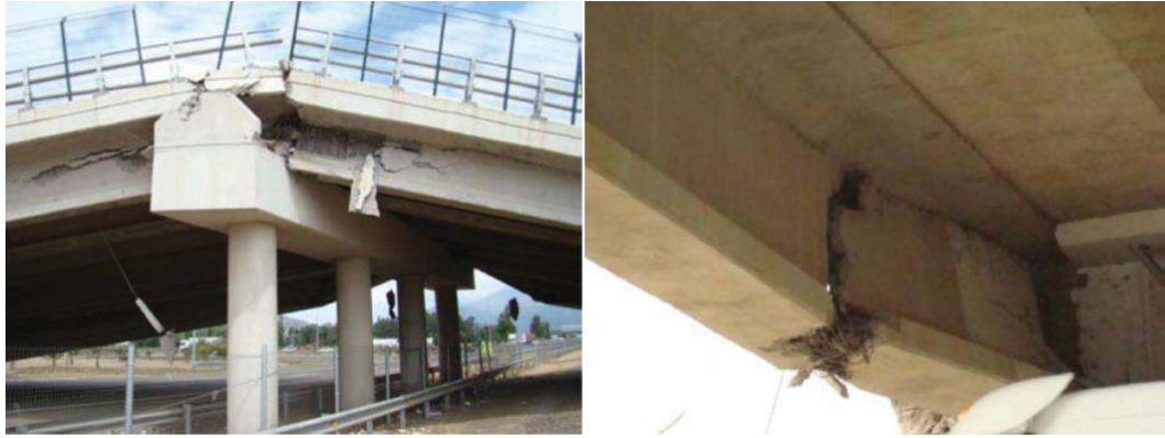
Figura 2.18. Colapso del vano producto de la falla por flexión y corte de las vigas principales. Puente Romero (Kawashima et al., 2011).
