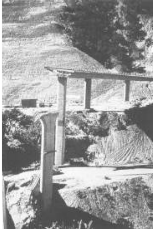
Figura 2.5. Colapso de un tramo entero de un puente, (Priestley et al., 1996).
