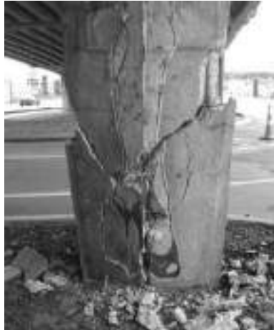
Figura 2.19. Fisuras diagonales de corte, falla de columna por pandeo de armadura debido a la flexión (Wotherspoon et al., 2011).
