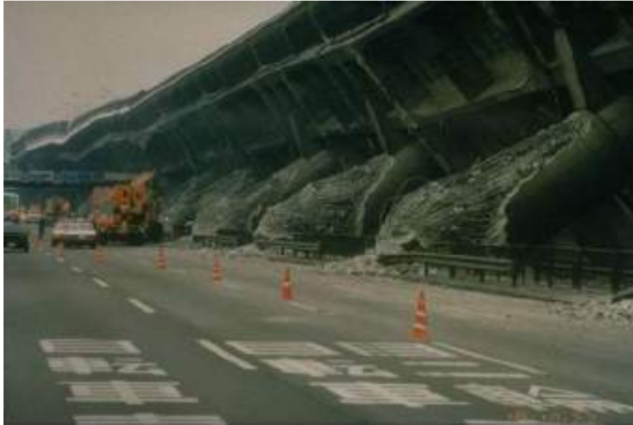
Figura 2.13. Colapso de 18 columnas de la autopista Hanshin-Expressway por flexión en la base, insuficiente ductilidad e inadecuado diseño del anclaje de barras de refuerzo (NISEE, 2016).
