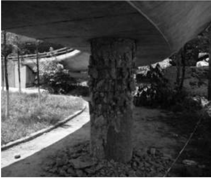
Figura 2.17. Falla por corte en pila del puente Huilan (Kawashima et al., 2009).
