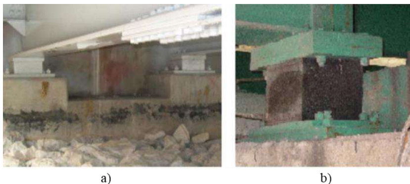
Figura.2.38. Dispositivos de aislamiento de goma de alta disipación instalados a) Indiana (HW50 Red Skeleton). b) Illinois (Wright et al., 2011).
