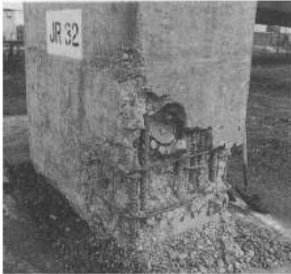
Figura 2.6. Daño en base de columna por deslizamiento de barras longitudinales (Priestley et al., 1996).
