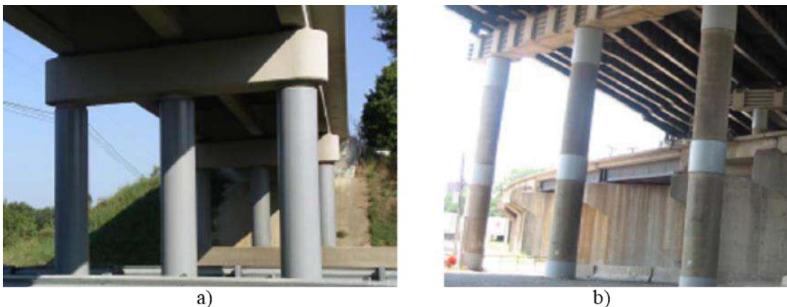
Figura 2.32. Encamisado metálico de columna en toda la altura de la autopista Interestatal I-40, Tennessee, Estados Unidos. b) Encamisado metálico parcial de columna en Missouri, Estados Unidos (Wright et al., 2011).
