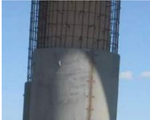
Figura 2.33. Recubrimiento de hormigón de columna en el puente Hernando DeSoto de la autopista Interestatal I-40, Tennessee (Wright et al., 2011).
