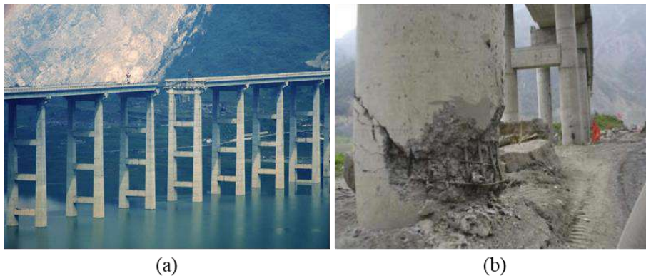
Figura 2.16(a) Puente de Miaoziping, desplome de un tramo completo por escasa longitud de asiento y descalce de vigas longitudinales [Wikipedia contributors, (2020)]. (b) Puente de Baihua, daño en pie de columna por insuficiente resistencia flexional, (Han et al., 2009).
