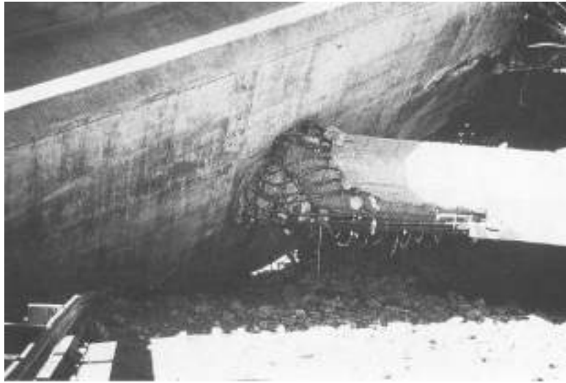
Figura 2.3. Falla por falta de confinamiento del hormigón en la cabeza de una columna (Priestley et al., 1996).
