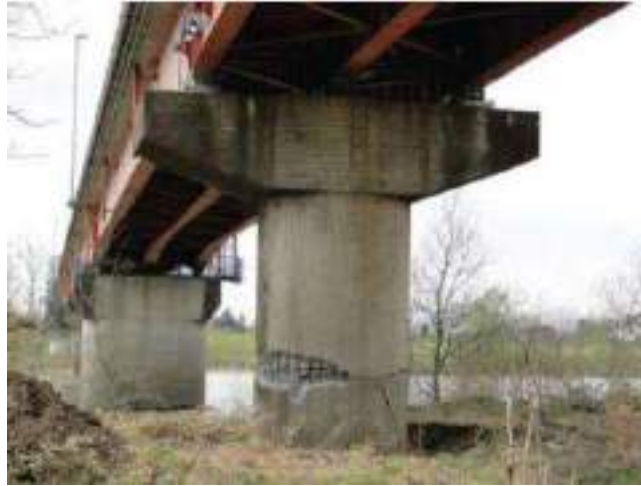
Figura 2.20. Falla de Corte en el puente de Fuji, cortesía de Dr. Hoshikuma en (Kawashima, 2012)
