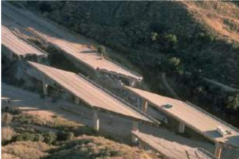
Figura 2.10. Colapso del Gavin Canyon Undercrossing sobre la interestatal 5, descalce del tablero producido por oblicuidad de ejes de las vías. (NISEE, 2016)
