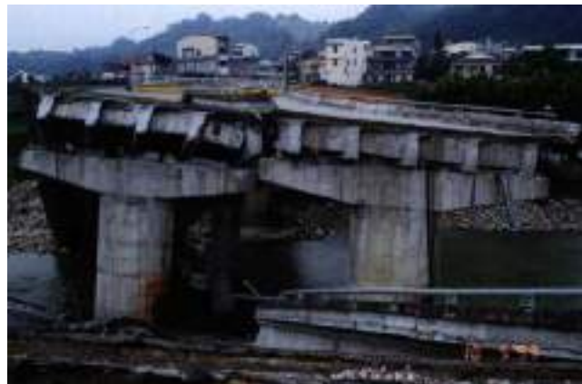
Figura 2.15. Puente Shi-wei en Taiwán. Rotura del capitel de las columnas (Chang et al., 2000)
