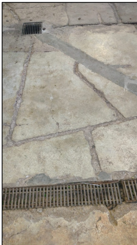
Figura 3: Estado actual de pisos de la fábrica.
