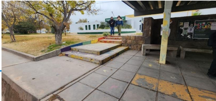
Barreras existentes: escaleras en el acceso al Comedor Universitario
