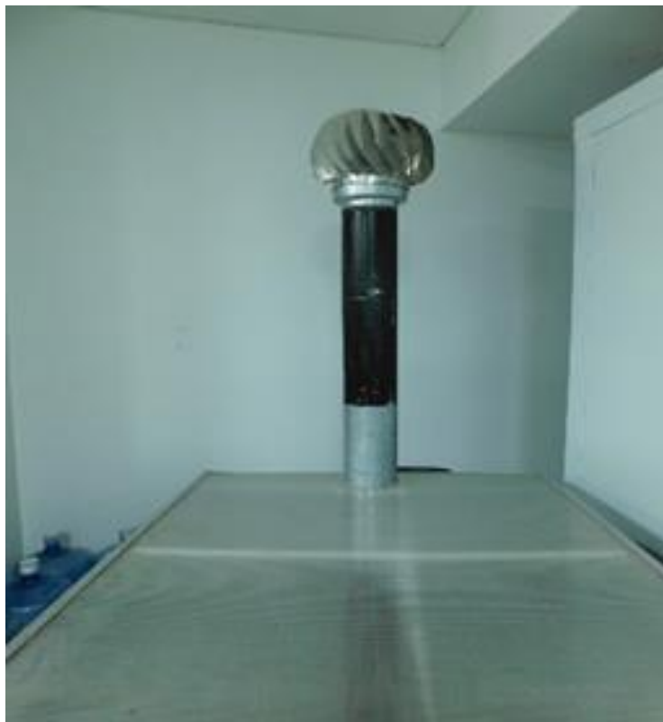
Figura 3.8: chimenea y extractor eólico
