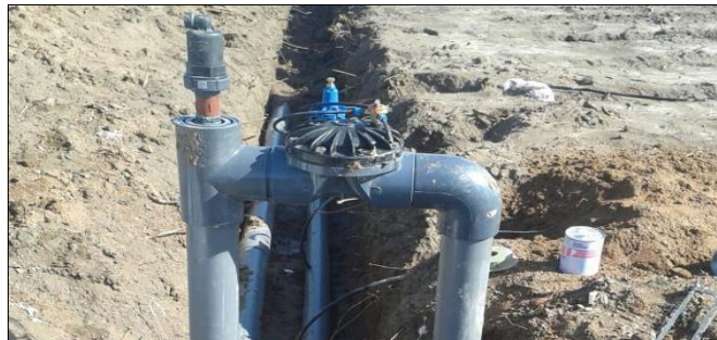
Figura 6: Riego por goteo subterráneo
